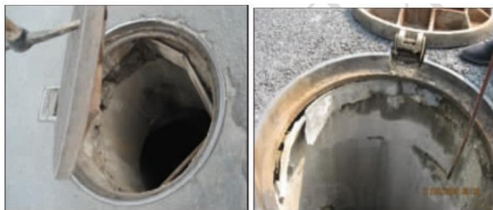
B.0.3 检查井上部井筒的典型破坏形式
